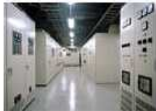
無停止運用のための電源設備
